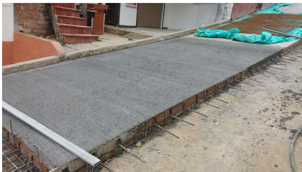
Ilustración 45 - Losa en concreto con rayado
