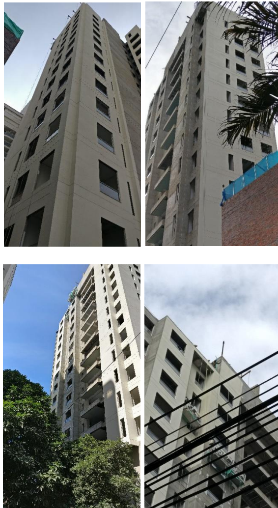
Figura 13, Fachada en la que evidenciaba las líneas horizontales, Moratto 44
