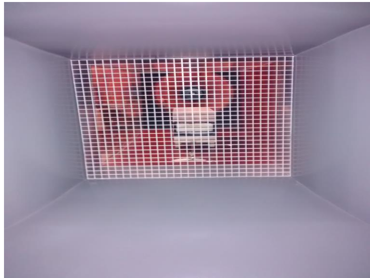
FIGURA 5: DIRECCIONADORES DEL FLUJO INSTALADO.
