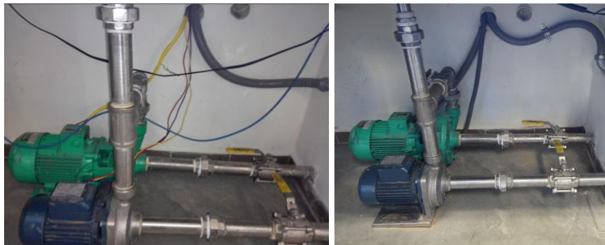
Figura 10. Cableado de las Bombas
