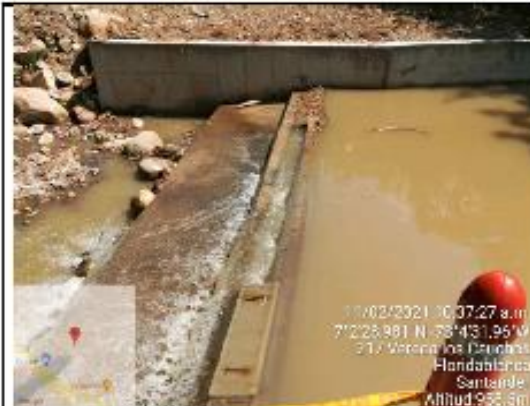
Imagen 5. Canal de Captacion sin su respectiva rejilla – Nueva Bocatoma.
