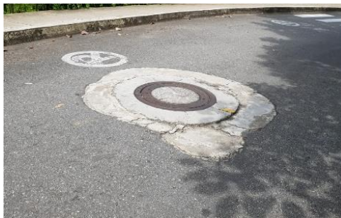
Imagen 3. Tapa de alcantarilla Fuente: Elaboración propia
