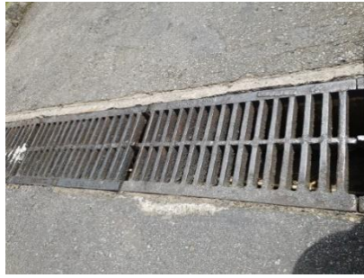
Imagen 5. Tapa de alcantarilla tipo rejilla. Fuente: Elaboración propia
