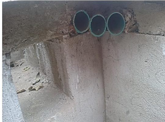
Figura 16. Ductería de 2" Fuente: Autor
