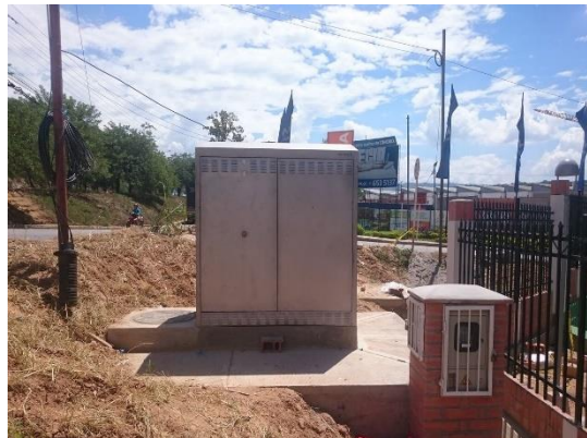
Figura 28. Equipo RSU en funcionamiento Fuente: Autor
