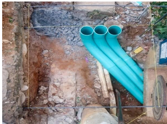
Figura 17. Ductería de 3" para las conexiones Fuente: Autor
