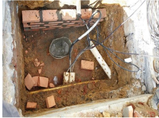
Figura 4. Rotura en cámara ubicada en la calle Fuente: Autor
