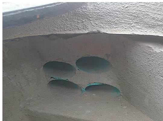
Figura 20. Ductería de rutas para los cables
