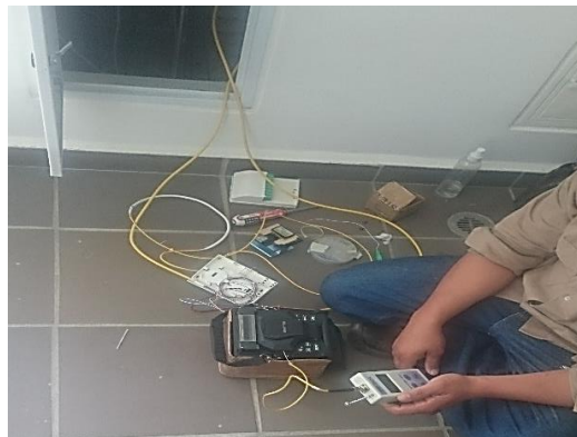
Figura 14. Empalme en caja de distribución Fuente: Autor
