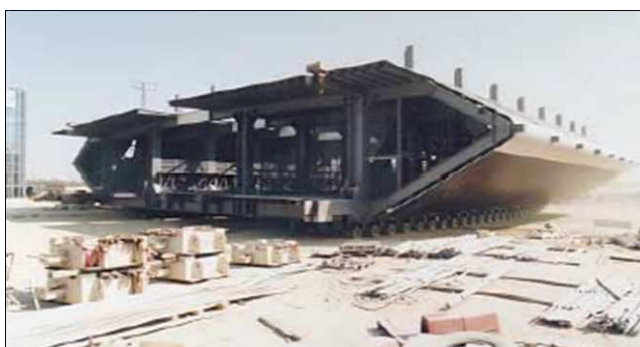
6.44. Módulo de tablero.
