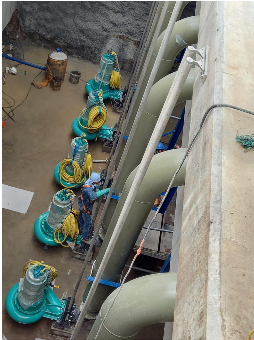
Ilustración 16: Bombas electro sumergibles estación de bombeo 3
