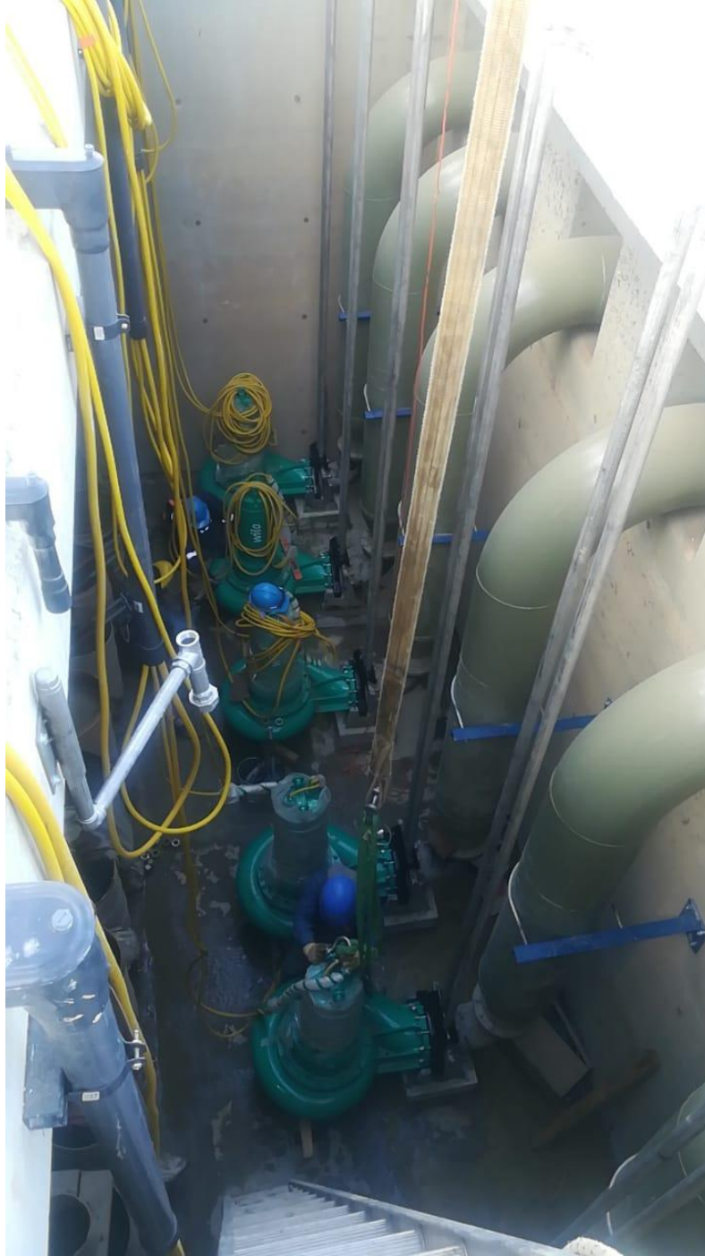
Ilustración 13: Bombas electro sumergibles estación de bombeo 1
