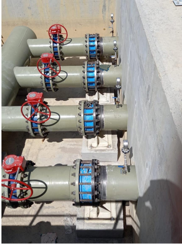
Ilustración 11: Válvulas y cheques en estación de bombeo 1
