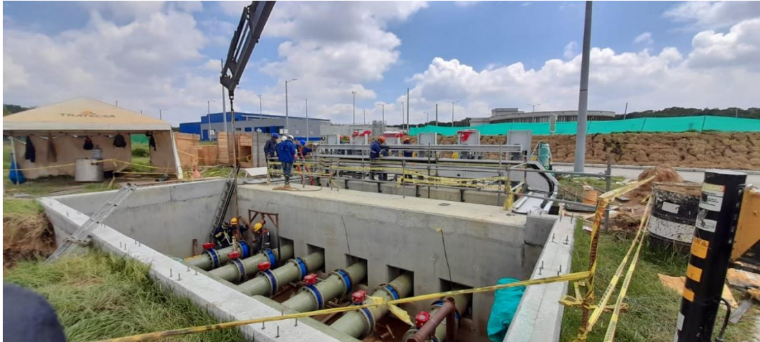
Ilustración 10: Estación de bombeo 1
