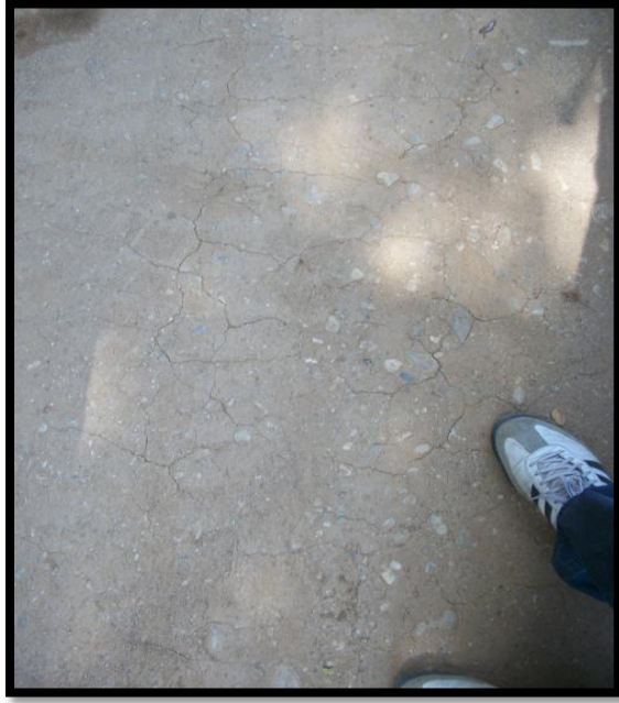
Fg3. Sub base con fracturamiento del terreno
