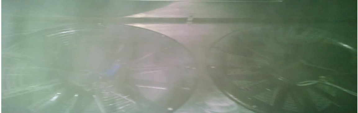
Figura 2. Cuartos fríos, Planta Frigo Andes
