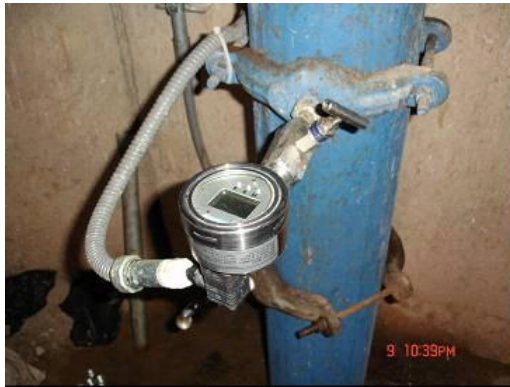
FIGURA 51: TRANSMISOR DE PRESIÓN LA CUMBRE
