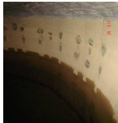
FIGURA 49: INTERIOR TANQUE ELEVADO
