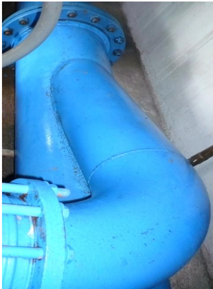
FIGURA 25: TUBERIA DE 10 PULGADAS
