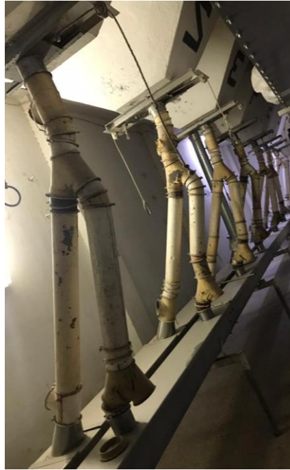
Figura 22. Ductos de transporte de harina
