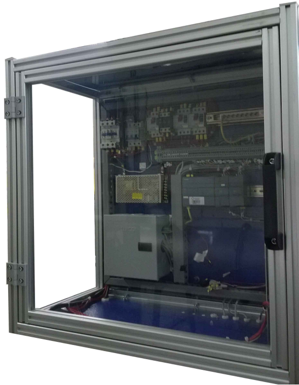
Figura 17. Gabinete de control.
