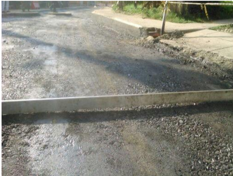
Figura 9. Evidencia de base por re nivelar (San Jorge). Elaboración propia.
