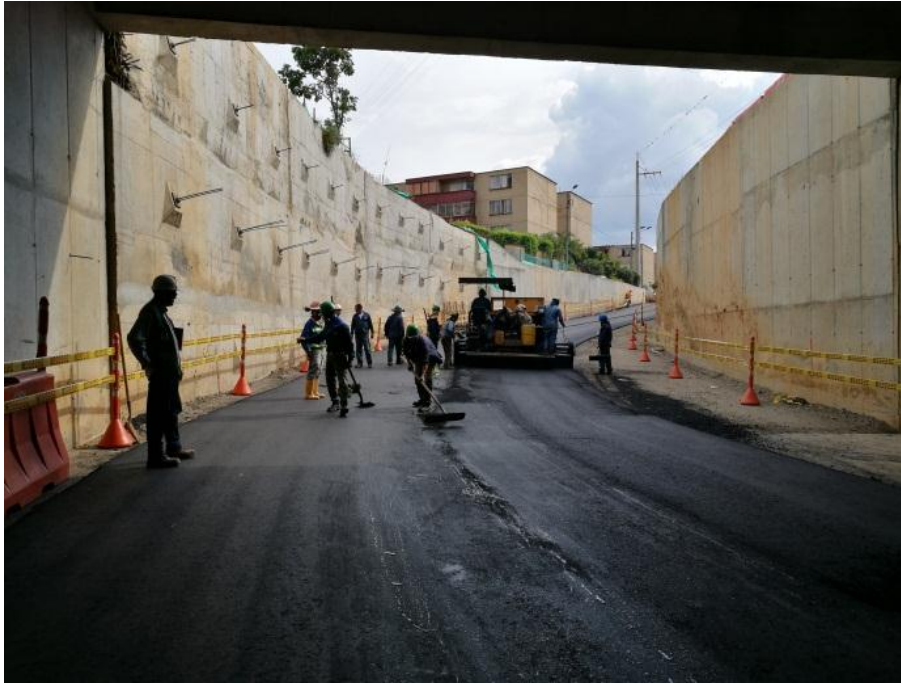
Figura 17. Extensión de la mezcla tipo MDC-2 con asfalto modificado en depresido (Tercer Carril).
