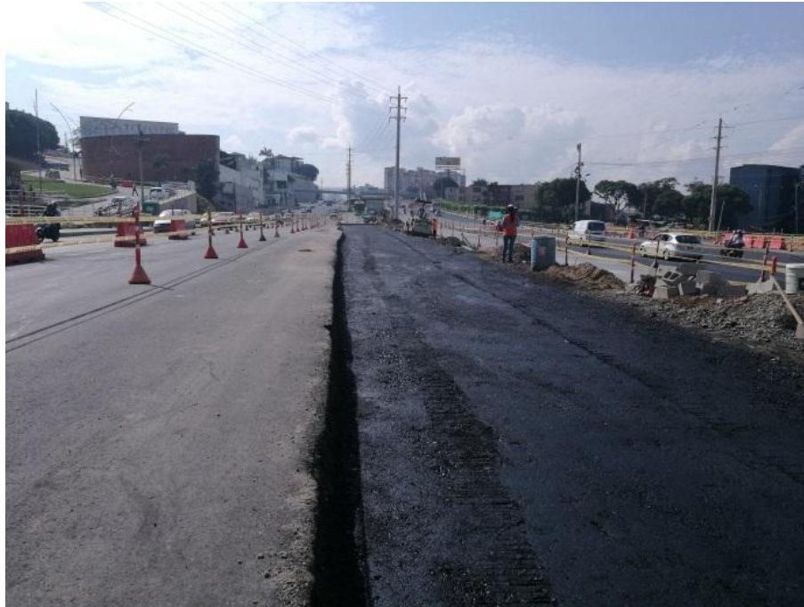
Figura 15. Superficie pavimentada en Autopista Bucaramanga-Floridablanca (Tercer Carril).
