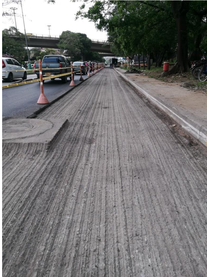
Figura 44. Superficie de fresado. Elaboración propia.
