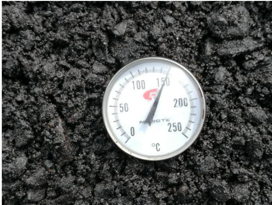
Figura 20. Evidencia de toma de temperatura de mezcla en la tolva. Elaboración propia.
