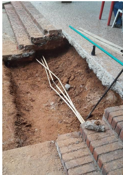
Ilustración 14 - Encuentro con red hidráulica y red eléctrica.
