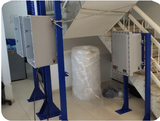
Figura 46 Estructuras para cofre NEMA 7 y cofre NEMA 4. Fuente: Autor
