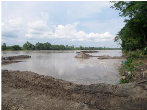
15/11/2014 Figura 17: Abscisas: K0+000/320; 2° nivel: K0+130/150-K0+206/236. Rompimiento del dique de protección.
