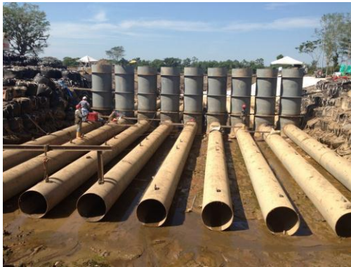
07/01/2014 Figura 36: tubería y cámara de compuertas, estructura de control
