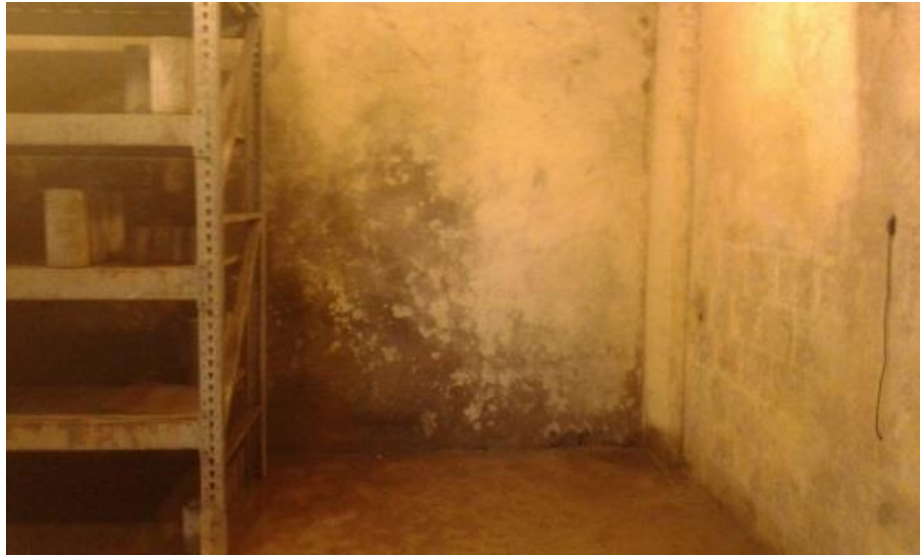
Ilustración 11 Cuarto de curado, espacio utilizado para viguetas
