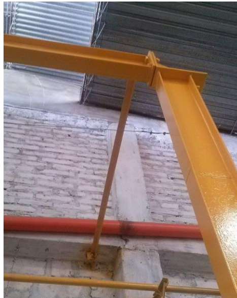
12) unión entre la viga, la columna y el ángulo de refuerzo. Fuente autor.
