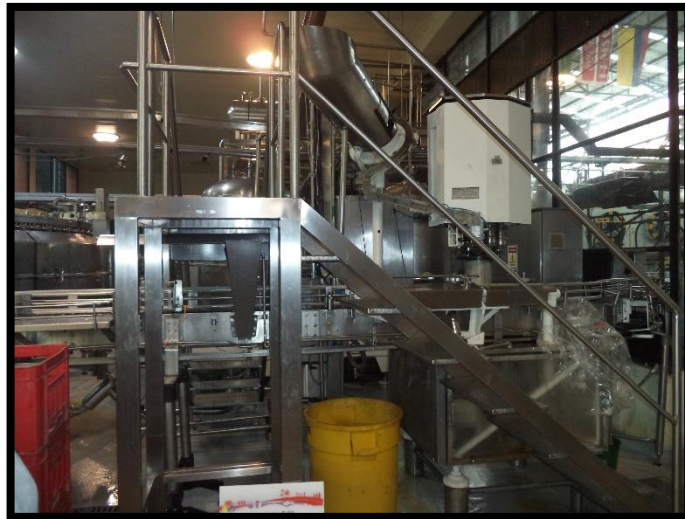
Figura. 70 Instalación bolsillo Capsuladora línea 2 embotellado
