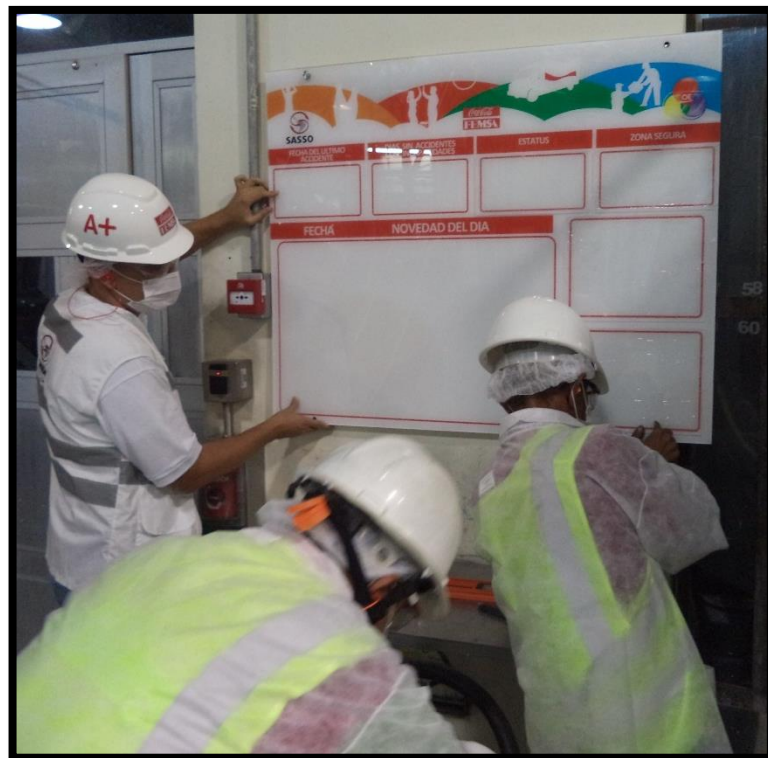
Figura. 84 Instalación tablero de control área de embotellado Coca Cola FEMSA Bucaramanga
