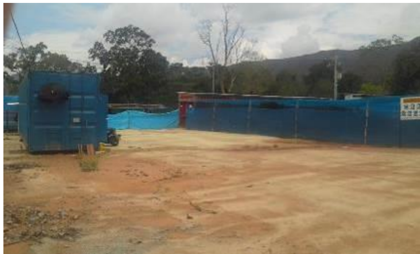
Imagen 6. Contenedor y almacén del proyecto.
