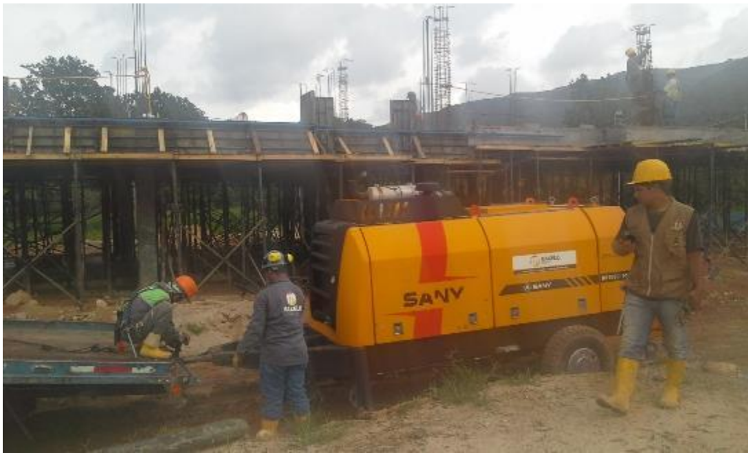
Imagen 40. Bomba estacionaria fundida modulo B.
