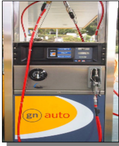
Figura 4. Imagen de un surtidor de gas natural comprimido vehicular
