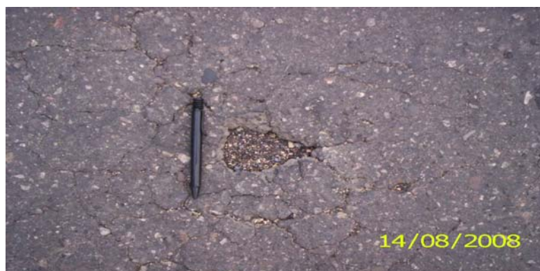
Figura 35. Tipo de Falla del Pavimento.
