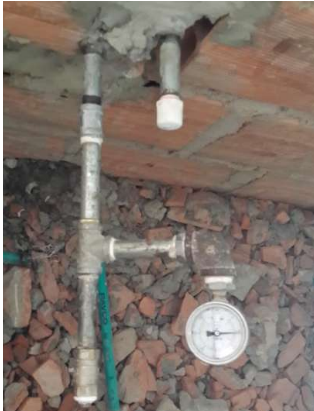
Imagen 22. Manómetro de presión de gas Apartamentos 03
