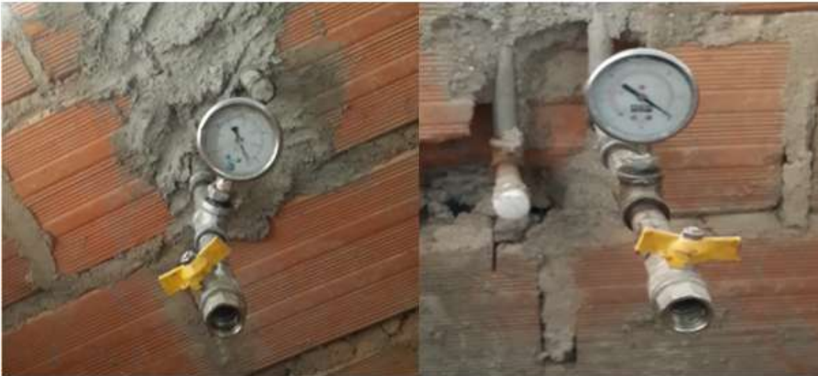
Imagen 21. Manómetro de presión de gas Apartamentos 01-02
