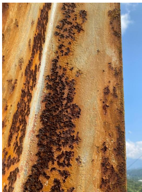
Corrosión por picadura
