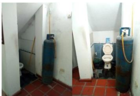
Figura 16. Desaseo y ausencia de puerta o cortina
