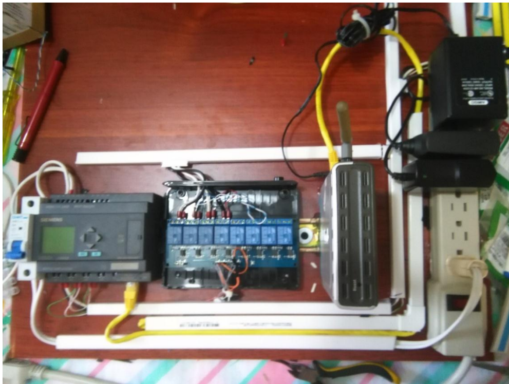
Figura 12. Vista superior PLC, Módulo Relé y Router. Fuente Autor.
