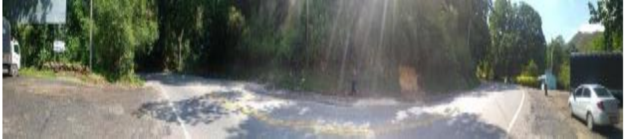
Ilustración 20. Estado de la vía Piedecuesta – Curos (punto El Caracolí)
