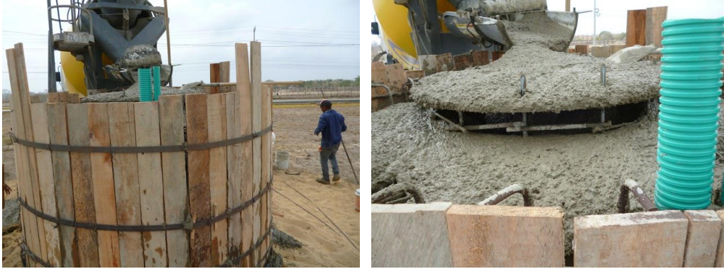
Fig. 73 Fundida Muro, Tapa de concreto. Fuente Arq Tatiana Yaguna
