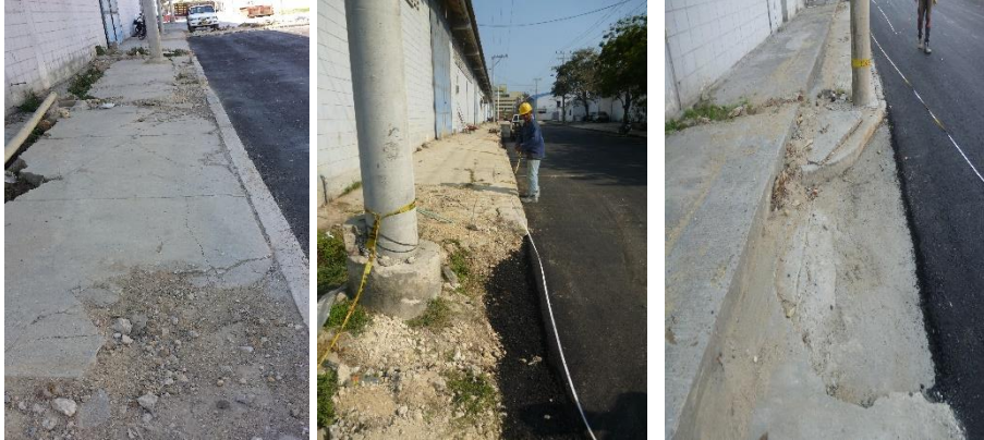
Fig. 18 Se evidencia el mal estado de los andenes y los bordillos. Fuente propia
