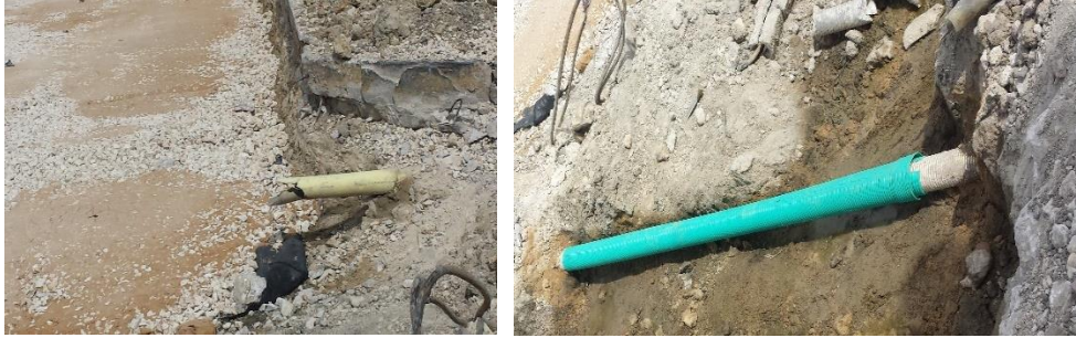
Fig. 34 Tuberías en mal estado. Fuente Propia
