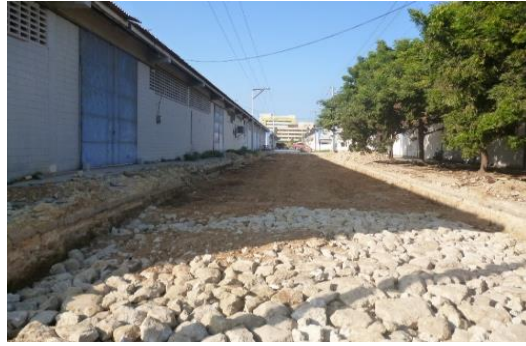
Fig. 5 Excavación y Mejoramiento de la subrasante con mezcla de piedra ciclopea y arena amarilla. Fuente propia
