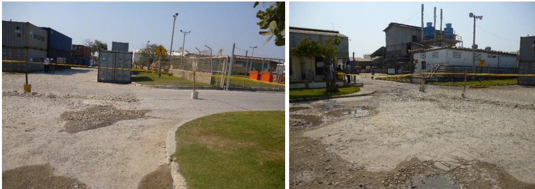
Fig. 42 Estado de la Vía. Fuente Propia
