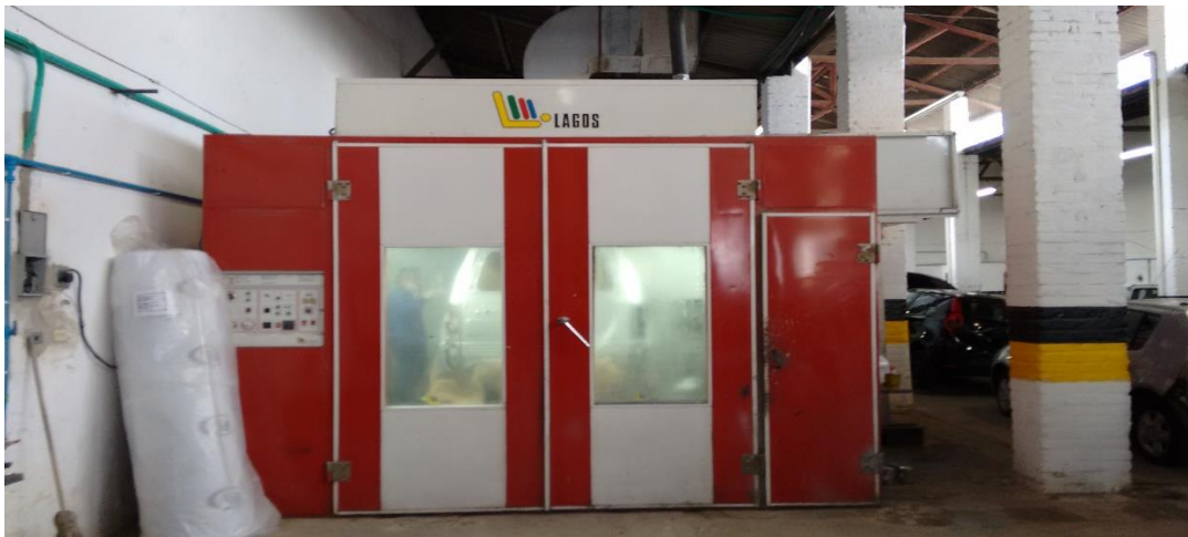
Fotografía 2. Cámara de pintura en establecimiento de latonería y pintura para vehículos.
