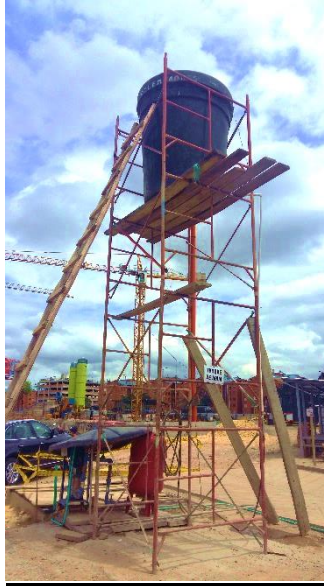
Figura 58. Sistema de recolección de aguas lluvias utilizado en obra
