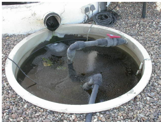
Imagen 17. Detalle de la bomba de activación del lecho bacteriano
