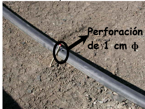
Imagen 14. Detalle de los orificios presentes en las tuberías de reparto
