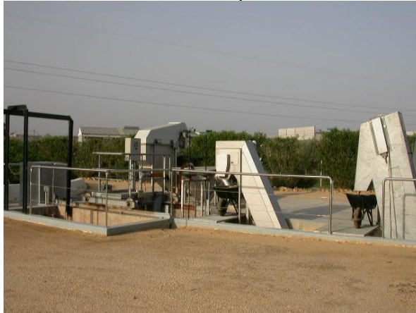
Imagen 4. Pretratamiento del sistema de depuración
