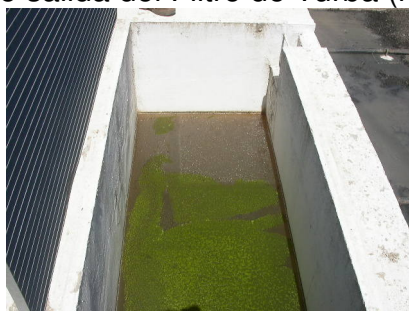
Imagen 18. Arqueta de salida del Filtro de Turba (modulo 1)
