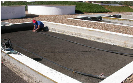
Imagen 6. Ubicación de las tuberías sobre los filtros a muestrear
