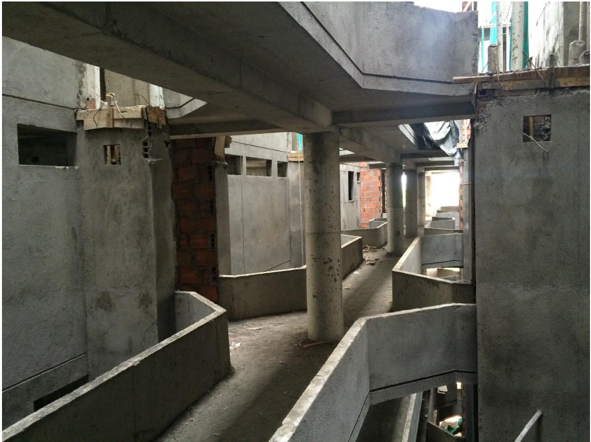
Figura 9. Viga decolgada de la placa maciza del puntofijo.
