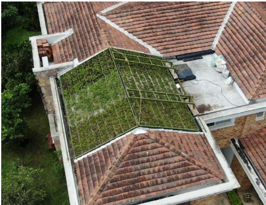
Ilustración 51 - Fotografía aérea de la cubierta verde instalada dos semanas posteriores a la fecha del montaje final
