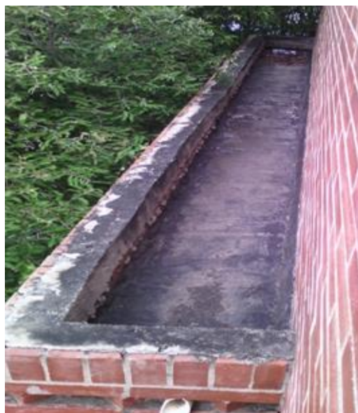
Figura 21. Viga canal del auditorio con filtraciones
