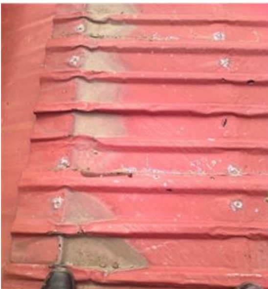
Figura 18. Filtración en cubierta salón de Biblioteca
