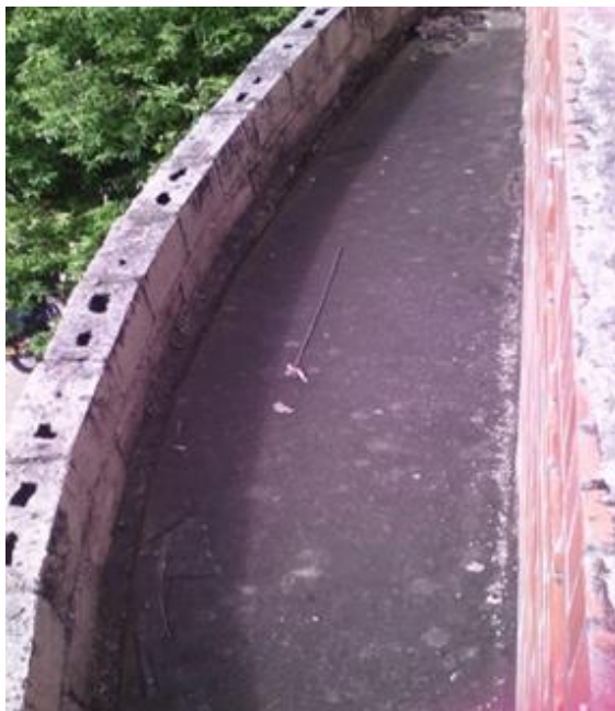
Figura 20. Placa en concreto con filtraciones
