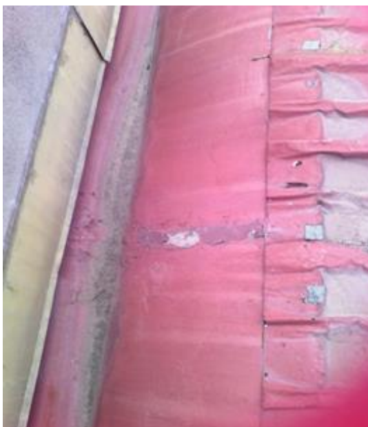
Figura 19. Canales metálicos con fisuras
