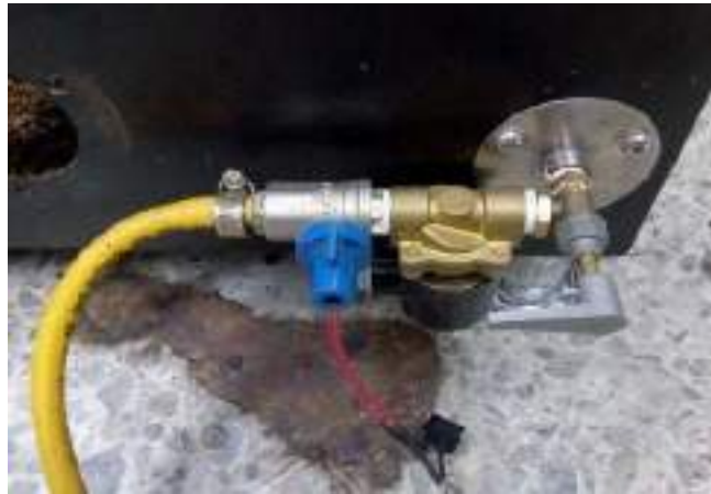
Ilustración 21 Instalación Electroválvula y válvula reguladora
