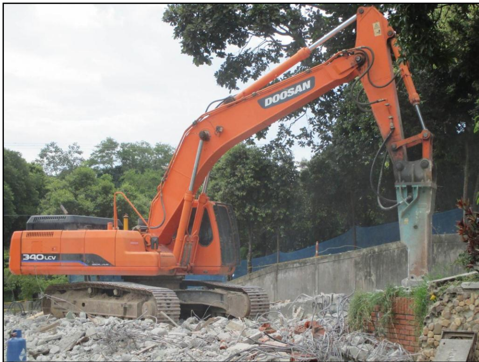
Figura 49. Escombros rampa oriental
