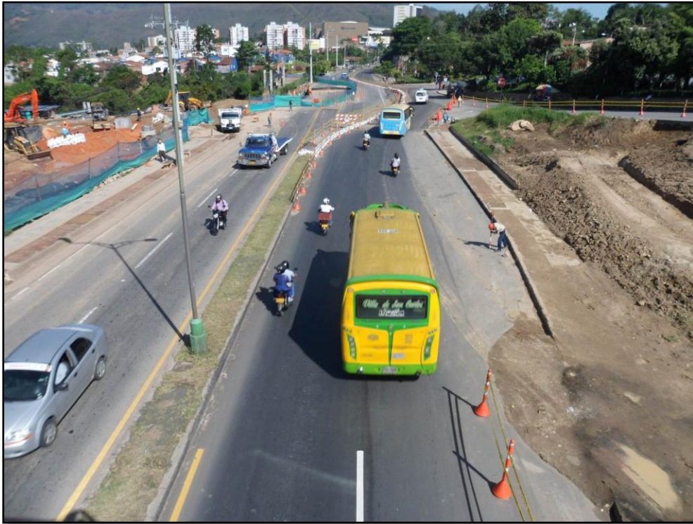
Figura 35. Variante terminada y en funcionamiento
