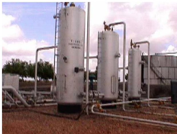
Figura 5. Tren de separación (Separadores de alta presión, baja y prueba) [1]
