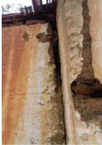
FIG 59. VISITA VIVIENDA AFECTADA
