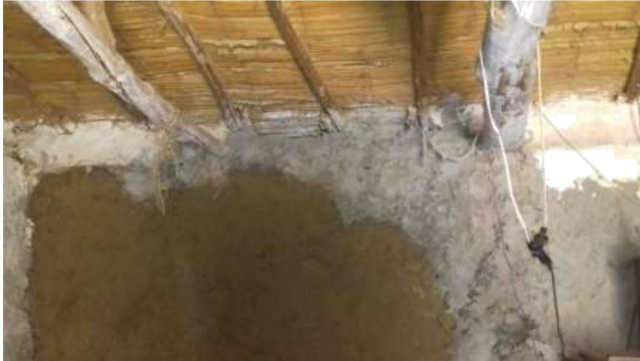
FIG. 72. VISITA VIVIENDA EN AMENAZA POR COLAPSO Fuente: Autor
