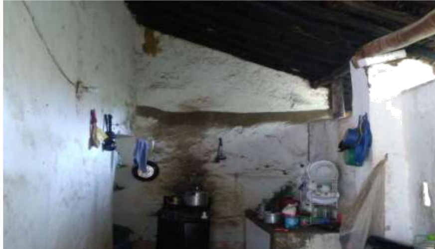
FIG. 70. VISITA VIVIENDA POR AMENAZA DE DESPLOME DE LA CUBIERTA Fuente: Autor
