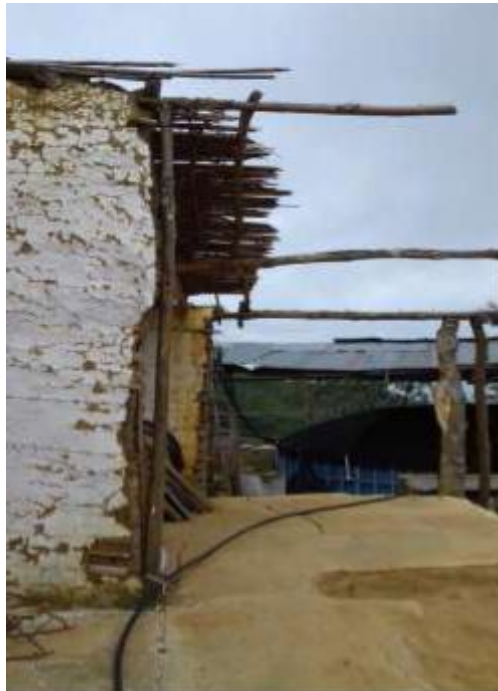
FIG. 71. VISITA VIVIENDA CON COLAPSO PARCIAL Fuente: Autor
