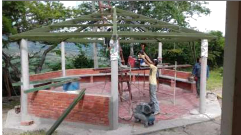
FIG. 30. SOLDADA DE LA CUBIERTA KIOSCO
