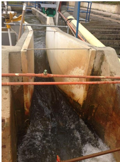
Ilustración 10. Canaleta Parshall sección de ampliación
