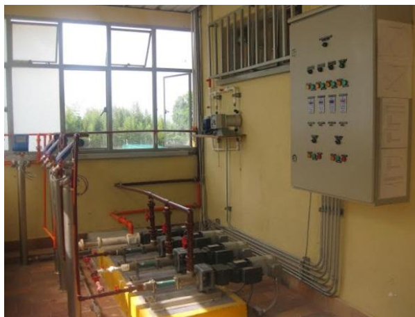
Ilustración 7. Bombas dosificadoras de coagulantes
