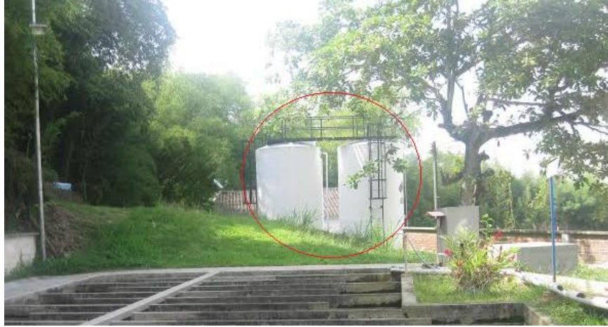
Ilustración 5. Tanques de almacenamiento
