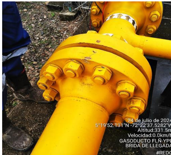
Fig. 46 Brida de entrada al city gate con falta de aislamiento en dos canutos Nota: fuente Inspección de juntas de aislamiento by REDO
