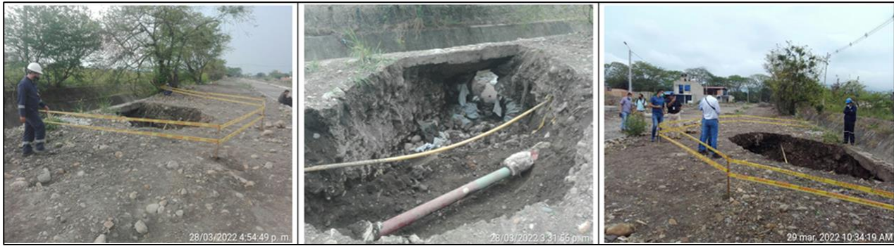
Fig. 55 Vandalismo en el PK 17+200
