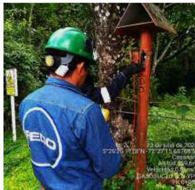
Fig. 29 Toma de potenciales poste a poste por parte de REDO
