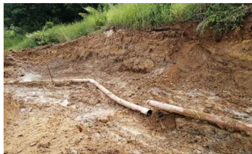
Fig. 2 Daño en tubería por remoción en masa en invierno, agosto 2023-PK 12+400
