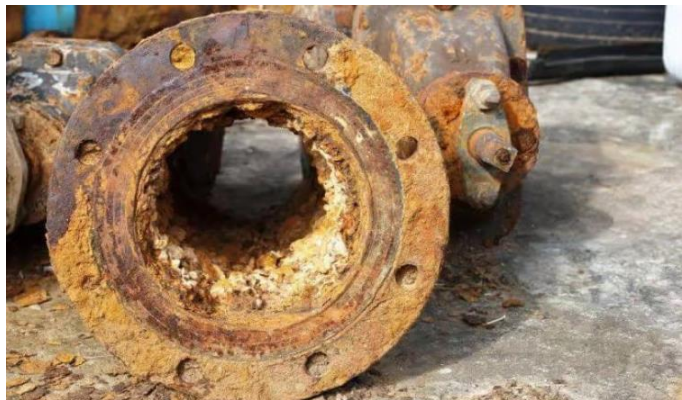
Fig. 6 Corrosión por MIC
