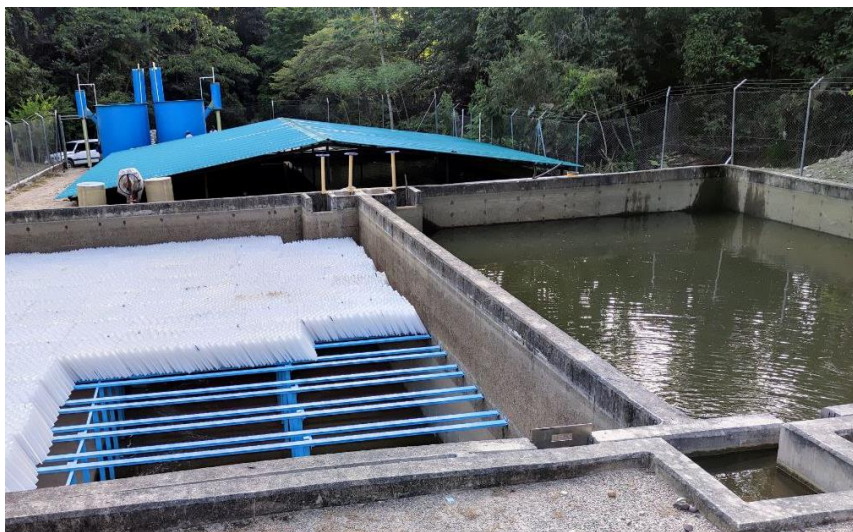
Imagen 4. Sedimentador de alta tasa (Izquierda) y presedimentador (Derecha)
