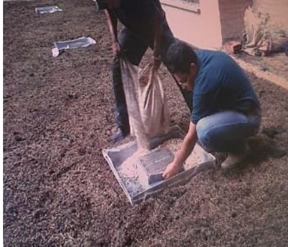
Figura 42. Abono y piedra para evitar taponamiento en los drenajes debido a la tierra.
