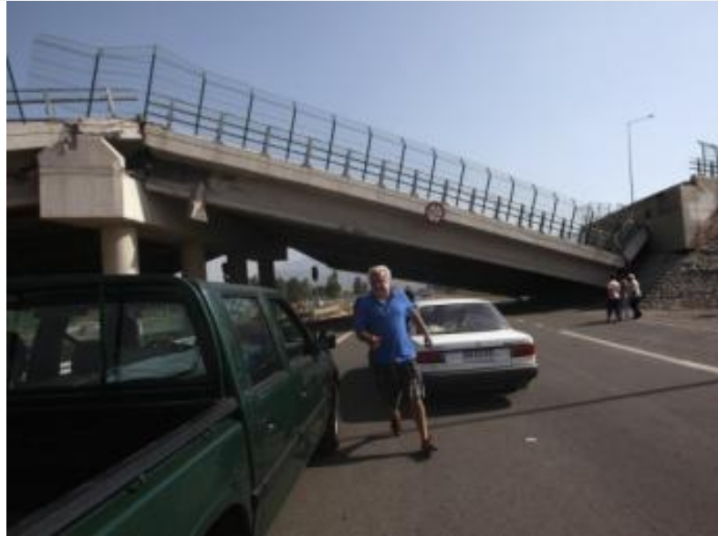
Figura 24. Fallo estructural de un puente por deficiente longitud de apoyo
