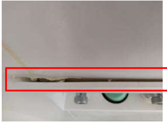
Detalle brecha caja lavadora. (Ejemplo)
