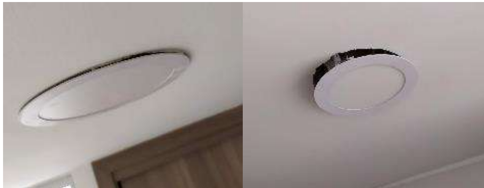
Luminarias sueltas en habitaciones.
