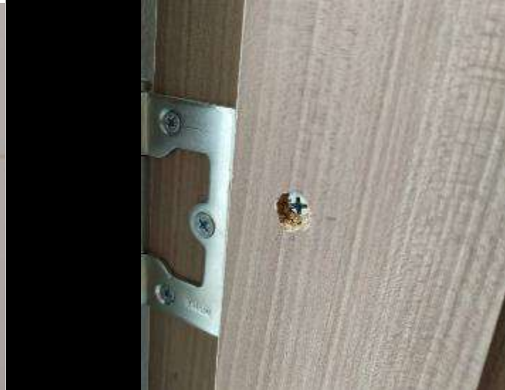
Puertas de habitaciones 2 y 3 les falta tapón en tornillo.
