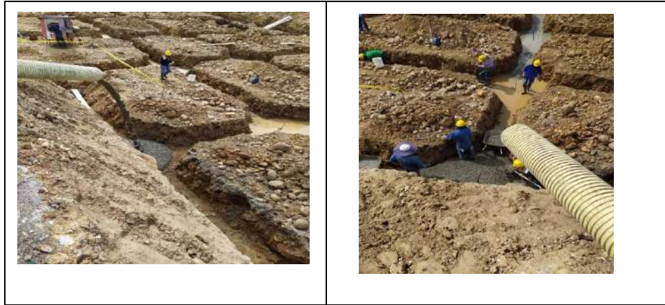
Figura 14. Supervisión de las actividades de zapatas, vigas y losa de cimentación incluido el acero de refuerzo
