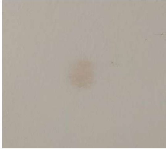
Figura 18. Mancha de grasa en pared de apartamento
