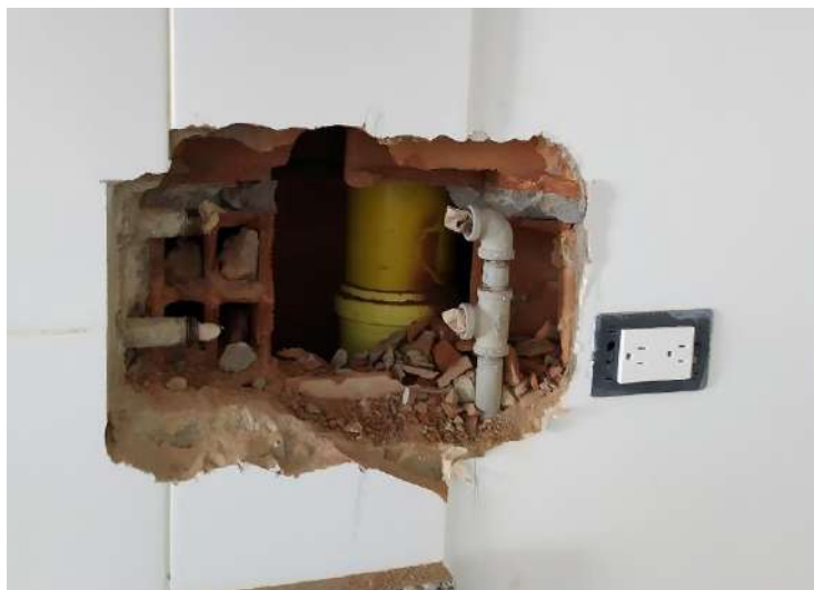
Figura 20. Red de gas cerca a toma corriente, apartamento 1501
