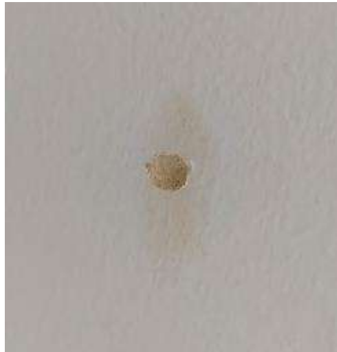
Detalle pintura pared dentro de closet hab. Principal.
