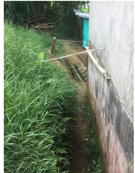
REGISTRO 32. Conexiones no planificadas.
