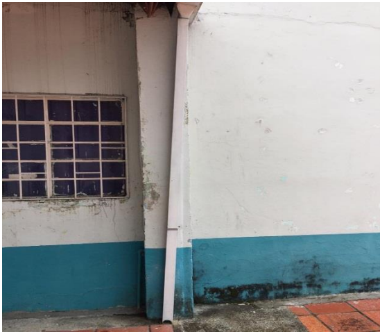
REGISTRO 39. Bajantes para aguas lluvias en mal estado.
