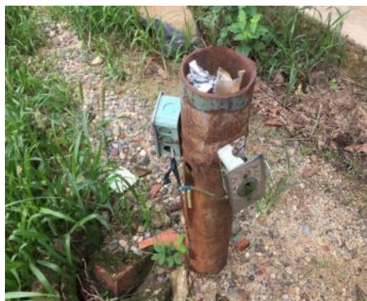
REGISTRO 22. Aparatos eléctricos en mal estado.
