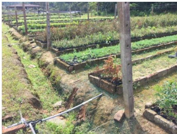
REGISTRO 3. Acometida a la Vista para sistema de riego.
