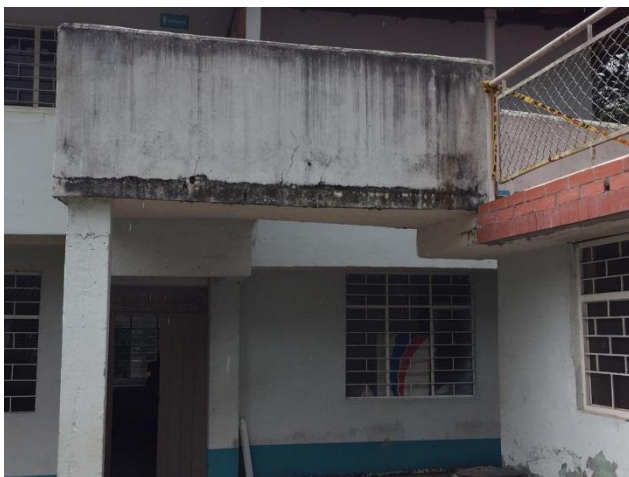
REGISTRO 41. Muros sin protección de alfajías.
