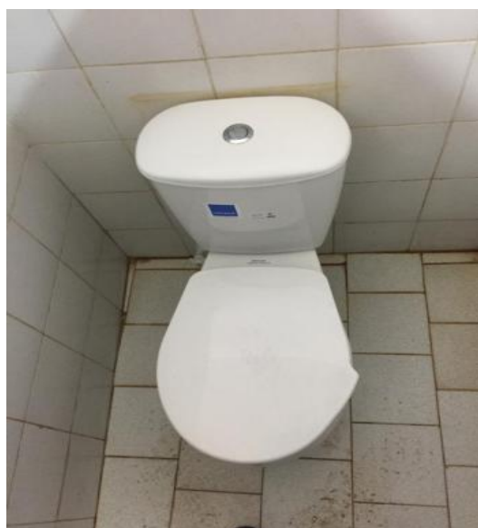
REGISTRO 23. Brechas de sanitarios en mal estado.
