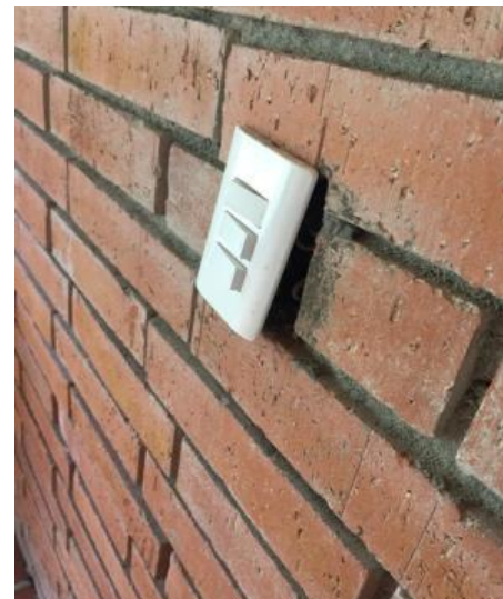
REGISTRO 9. Tomas en mal estado.
