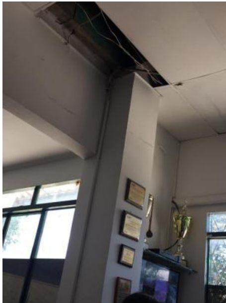
REGISTRO 14. Cielo existente en mal estado.
