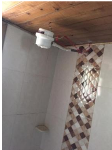
REGISTRO 6. Instalación de duchas eléctricas en mal estado.
