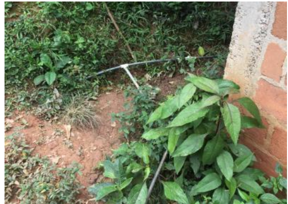
REGISTRO 26. Acometida hidráulica a la vista.
