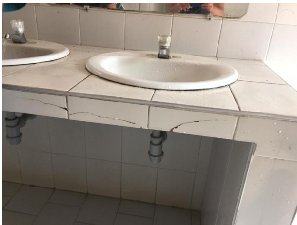
REGISTRO 37. Deterioro en enchapes de cerámica.
