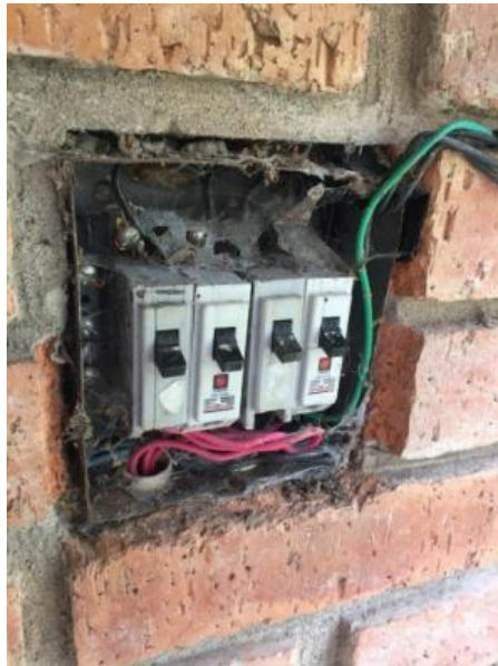
REGISTRO 12. Caja de automáticos sin protección.
