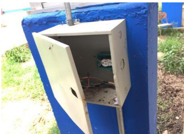
REGISTRO 21. Caja de distribución eléctrica sin protección.
