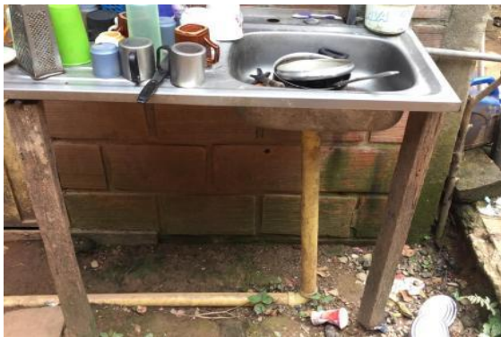
REGISTRO 27. Lavamanos puesto de manera rudimentaria.
