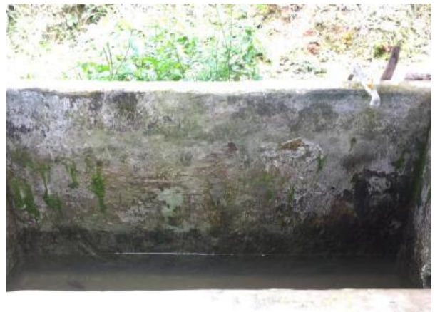
REGISTRO 28. Tanque de recolección de agua.
