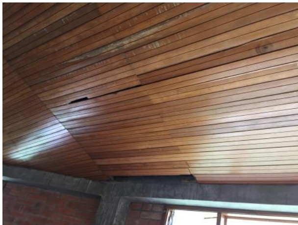
REGISTRO 8. Cubierta de madera en mal estado.
