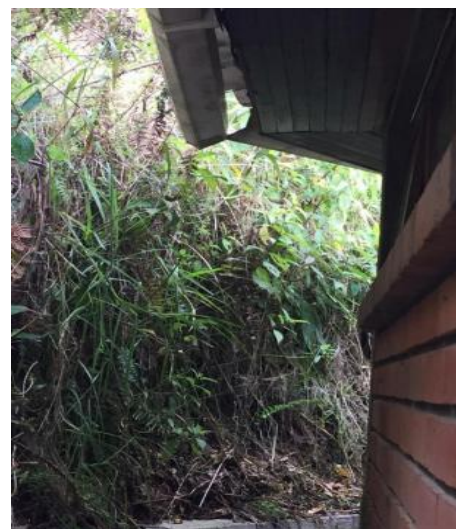
REGISTRO 11. Canalización de cubiertas con desajuste.
