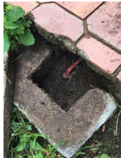
REGISTRO 7. Llave de paso principal en mal estado (no gira).
