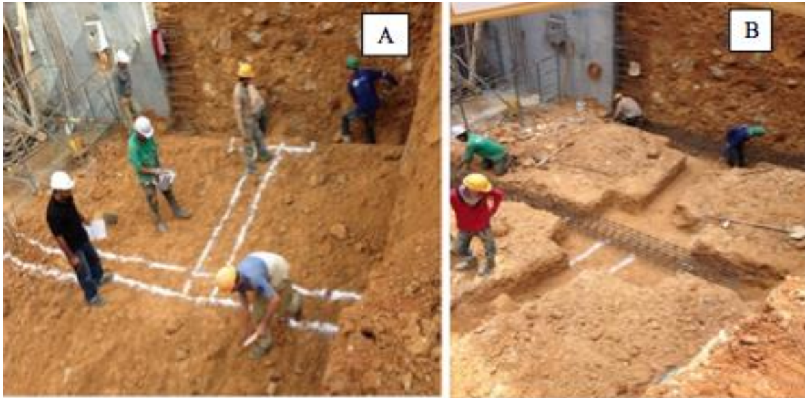
Figura 28. A. Ejes de vigas y zapatas con cal. B. Excavación vigas y zapatas.
