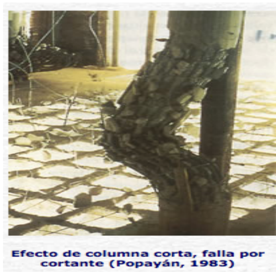
Figura 4. Efecto de columna corta, falla por cortante (Popayán, 1983)
