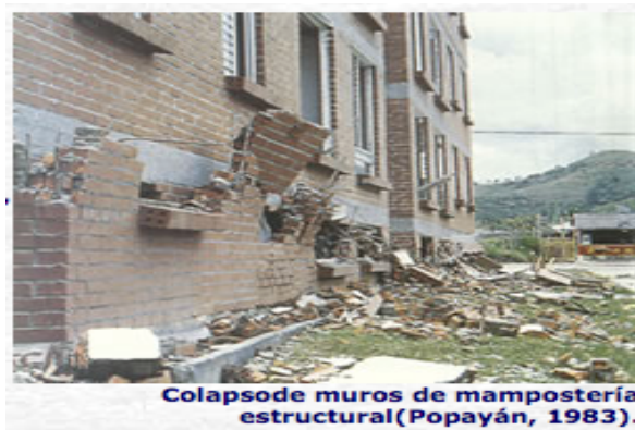
Figura 2. Colapso de muros de mampostería estructural (Popayán, 1983)
