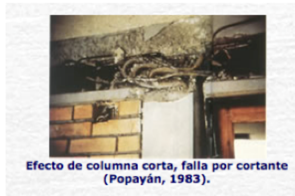
Figura 3. Efecto de columna corta, falla por cortante (Popayán, 1983)
