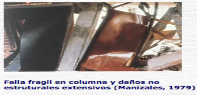
Figura 5. Falla frágil en columna y daños no estructurales extensivos (Manizales, 1979)
