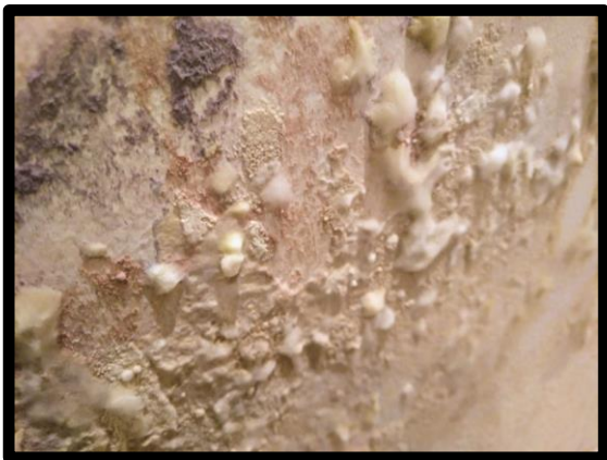
Figura 9. Patología de Mohos y Hongos
