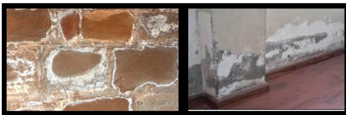
Figura 7. Patología de Eflorescencias en muros de piedra y de ladrillo
