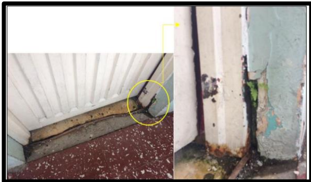
Figura 12. Presencia de Corrosión por Humedad
