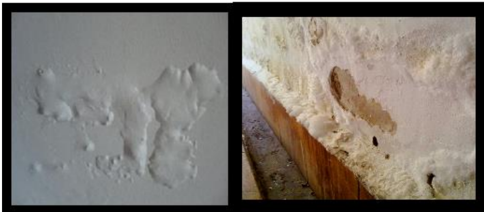
Figura 5. Afectación de estucos y paredes interiores
