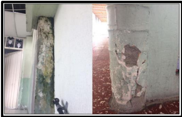
Figura 13. Erosión en Paredes
