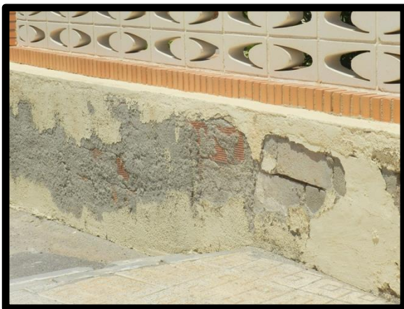
Figura 10. Deterioro de concretos
