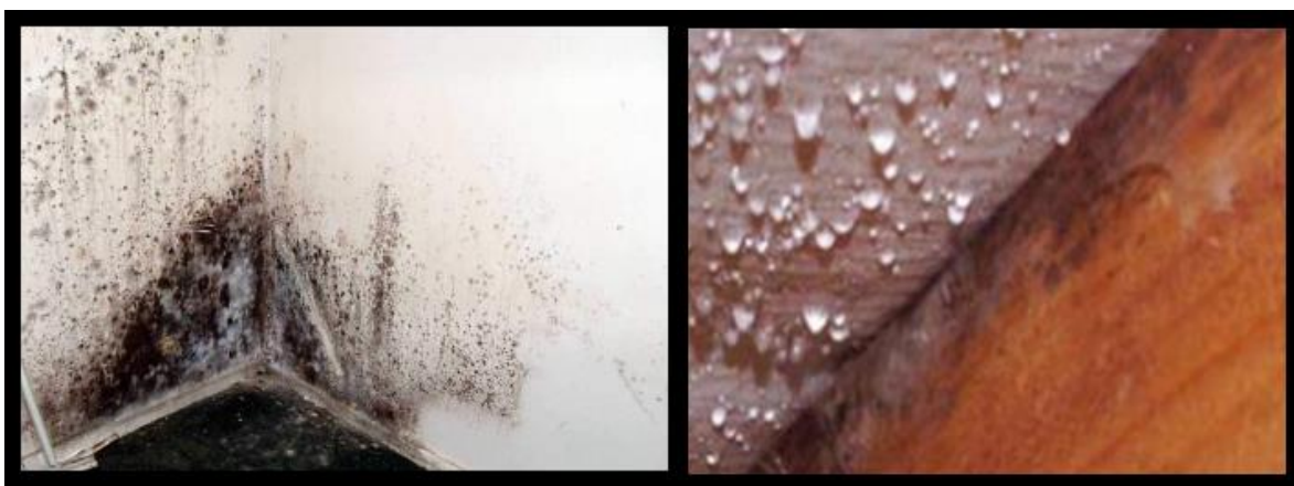
Figura 4. Patología estructural de Mohos por condensación
