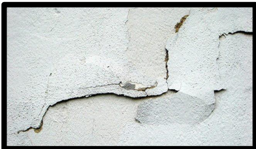
Figura 11. Fisuras, dilataciones y grietas en Materiales
